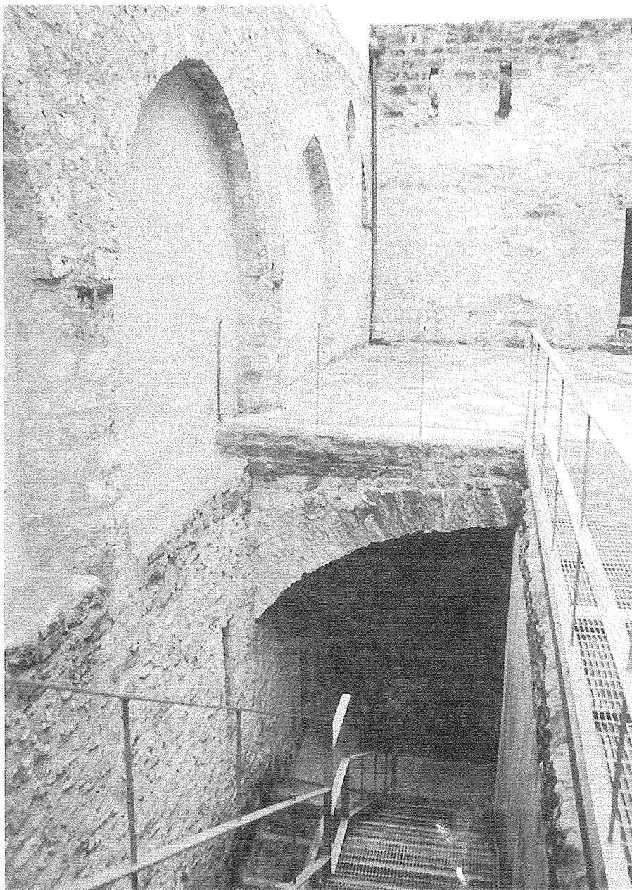
Fig. 26 - Palermo, Complesso di San Giovanni degli Eremiti: particolare dei pilastri cilindrici sulla parete esterna occidentale dell'edificio esistente a Nord del chiostro, dopo i restauri.
